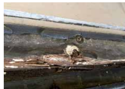
Een detail van het oorspronkelijke Meranti stelkozijn, beschimmeld en verrot
